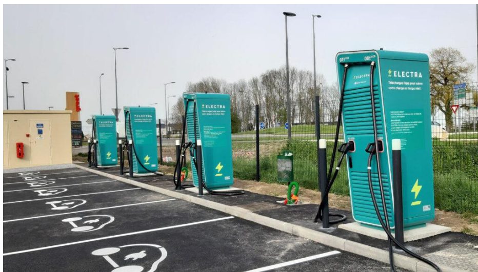
Figure 20 : Bornes de recharge rapide pour véhicule électrique Electra
